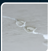
Škody spôsobené z kvapkajúcich stropov
